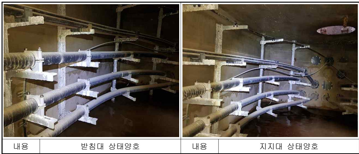
【사진 3.4】 부속 및 부대설비 현황
