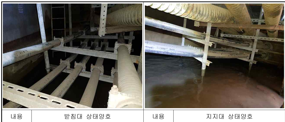
【사진 3.8】 부속 및 부대설비 현황
